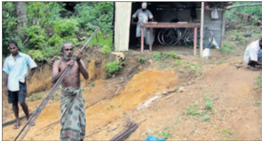
So sah es gestern auf der Baustelle aus: Arbeiter bereiten die Fundamente vor. PN-Foto: Verein Interhelp
