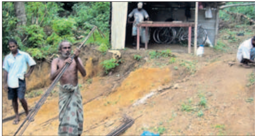
So sah es gestern auf der Baustelle aus: Arbeiter bereiten die Fundamente vor. PN-Foto: Verein Interhelp
