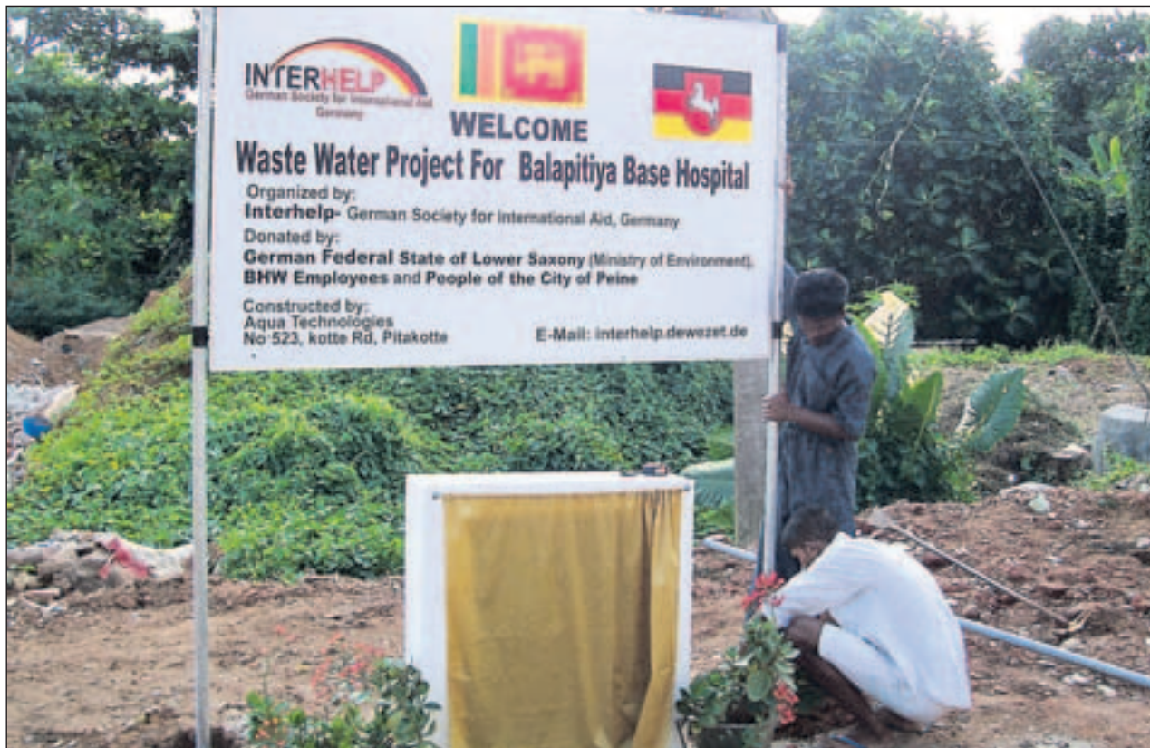
Vorbereitung für die Grundsteinlegung am Krankenhaus in Balapitiya. Das Baustellenschild weist auf den Spendenbeitrag der Peiner Bürger hin. PN-Foto: Verein Interhelp
